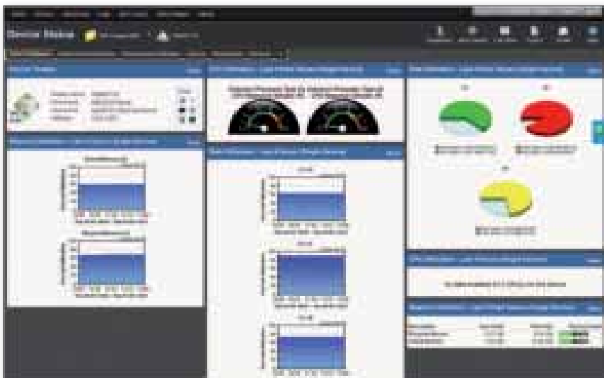
Übersicht im Rechenzentrum RIO pro Servergruppe
